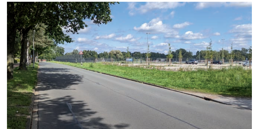
Auf der rechten Seite wird ein Geh- und Radweg erstellt. Unter anderem hier entsteht eine Querungshilfe für die Besucher des Sportplatzes.
